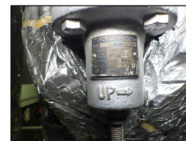
既存 減圧弁 高圧→中圧
