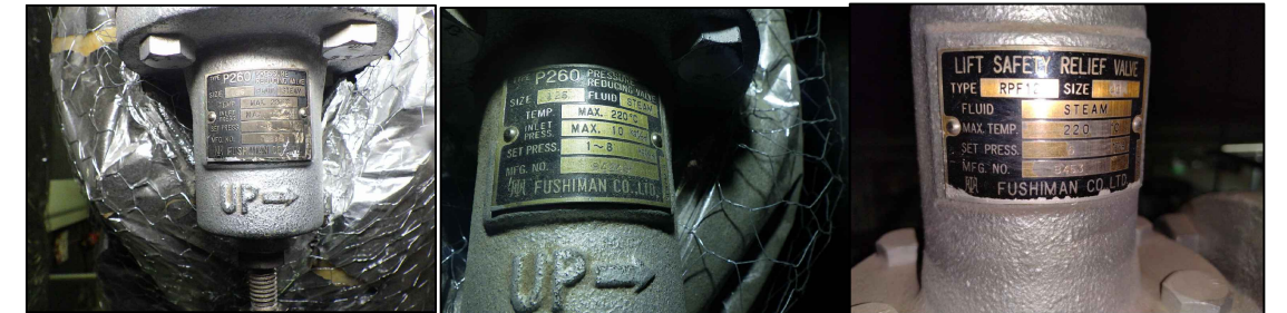
既存 減圧弁 高圧→中圧
