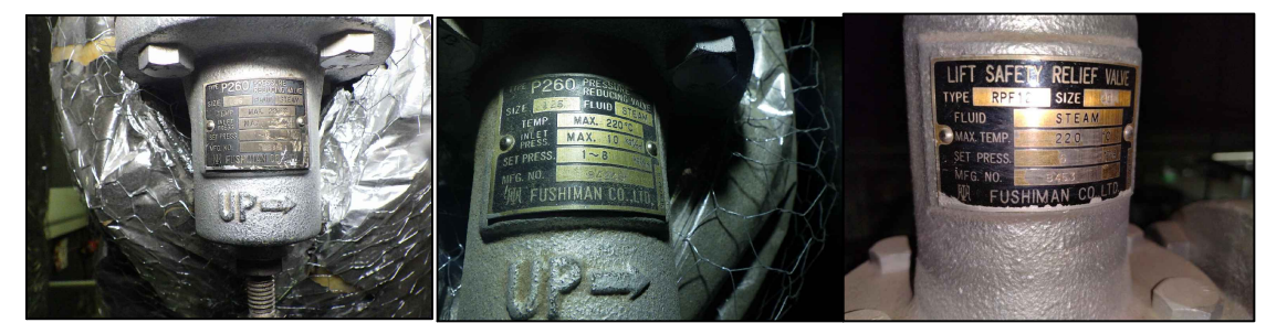
既存 減圧弁 高圧→中圧
