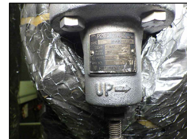
既存 減圧弁 高圧→中圧
